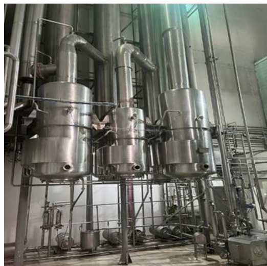
Figura N°3: Evaporador de 3 efectos.
